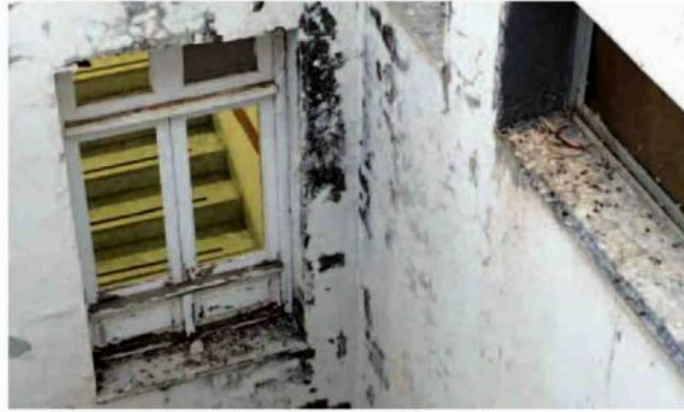
Paredes llenas de humedad y ventanales de madera podridos. | CEP
